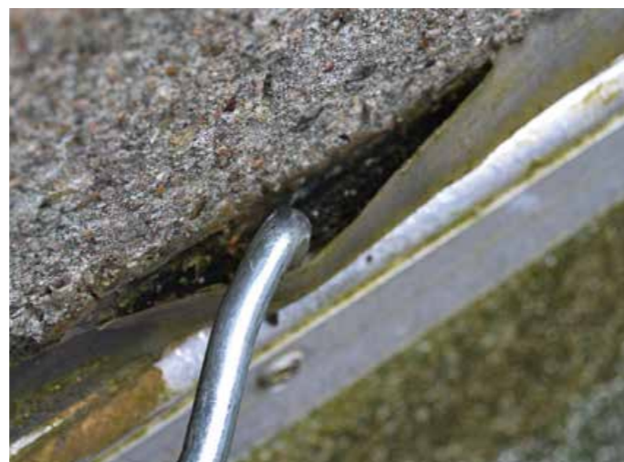
▲ Hier fehlt was: Fehlende Zusatzmaßnahmen sorgen oft für Undichtigkeiten
