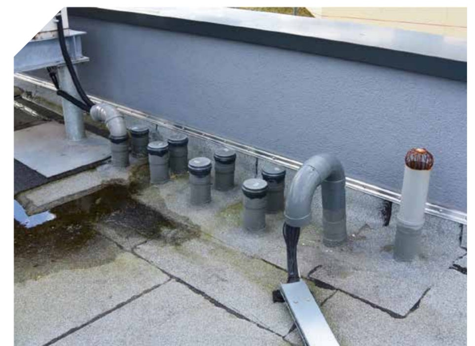
▲ Zu eng: Durchdringungen sollten in einem Abstand von mindestens 30 cm geplant werden
