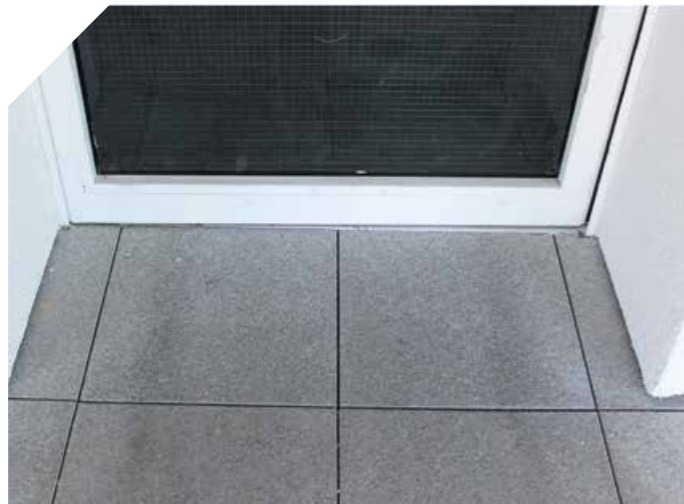
▲ Zu niedrig: Die Anschlusshöhe sollte hier mindestens 15 cm betragen
