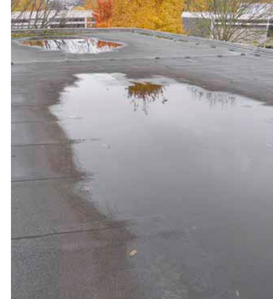
▲ Regenwasser sollte, anders als hier, durch ein Gefälle schnell vom Dach geleitet werden
