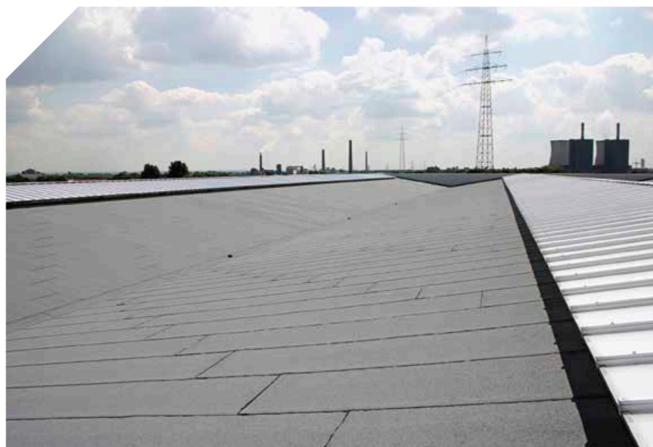
▲ Keine Chance für stehendes Wasser: Das Gefälle dieses Dachs verhindert Pfützenbildung zuverlässig
