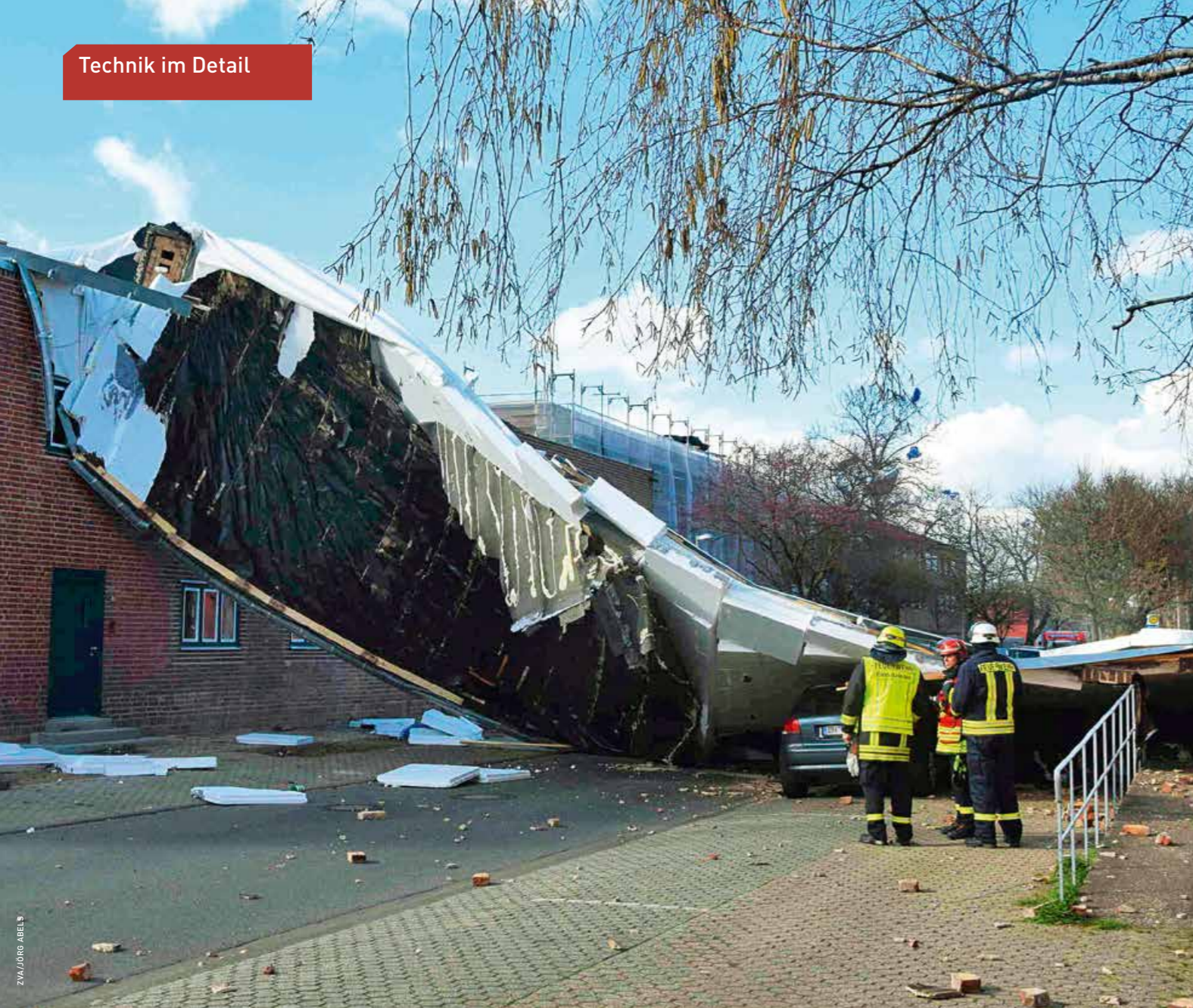
▲ Totalschaden: So kann es aussehen, wenn der Wind bei heftigem Sturm unter die Abdichtung kommt – dann wird oft der komplette Dachaufbau abgeschält
