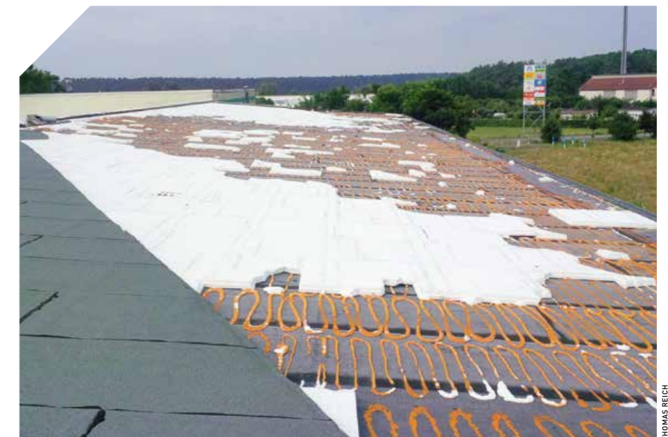
▲ Sturmschaden von oben: Am größten sind die Windsogkräfte in den Ecken und an den Dachrändern
