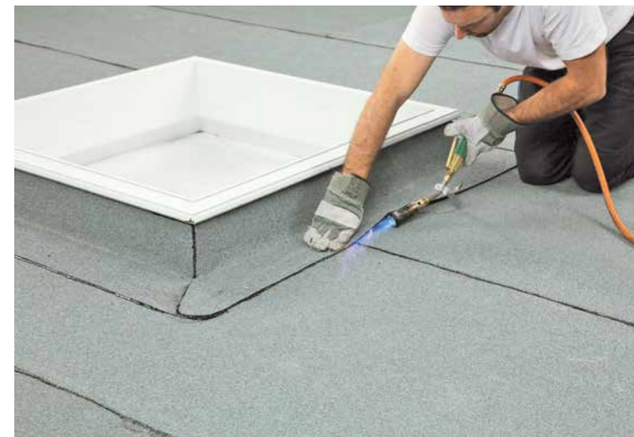
▲ Bei der Abdichtung von Details ist besondere Sorgfalt geboten, da hier die meisten Fehler auftreten
